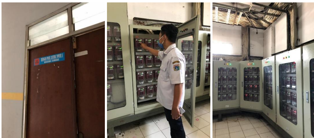
Foto kegiatan saat kontrol panel listrik di Tower A Rusunawa Tambora.
